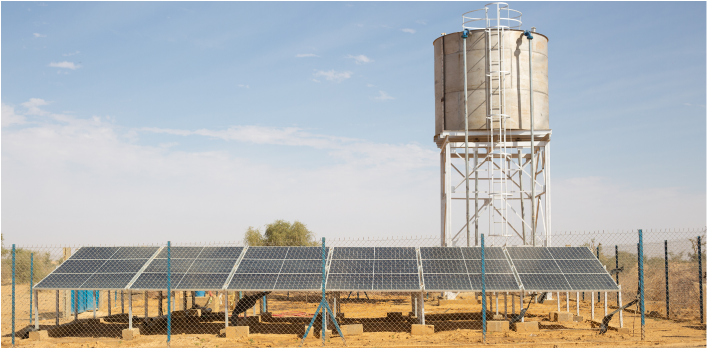
mini-adduction d'eau potable (AEP) par système photovoltaïque construite dans le cadre du PDU dans le département de Filingué
